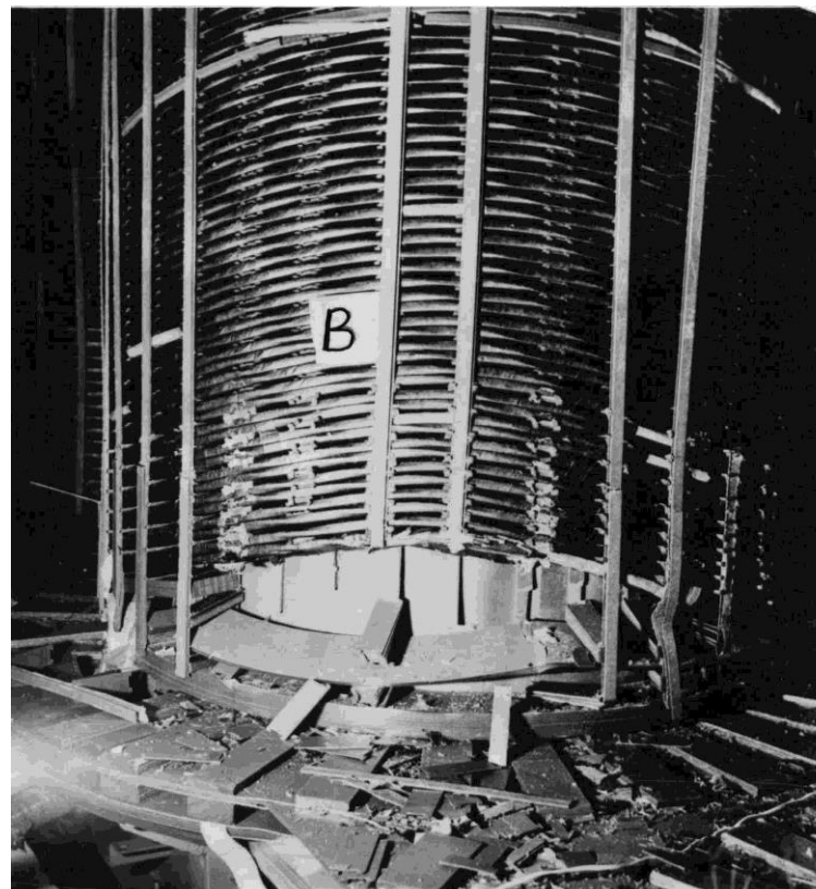
Осевые деформации обмотки НН трансформатора типа ТДЦ-250000/220 ( \Delta Z_k = +20\% ).
